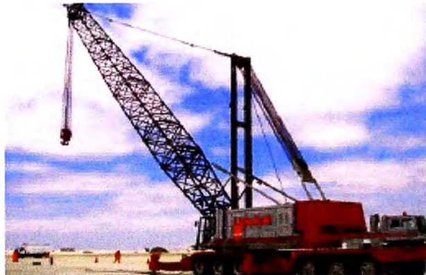
Figura 2.11 – Grúa de Celosilla
