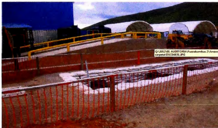
Figura 3.6 – Lavadero de equipos del Proyecto Nueva Fuerabambas
