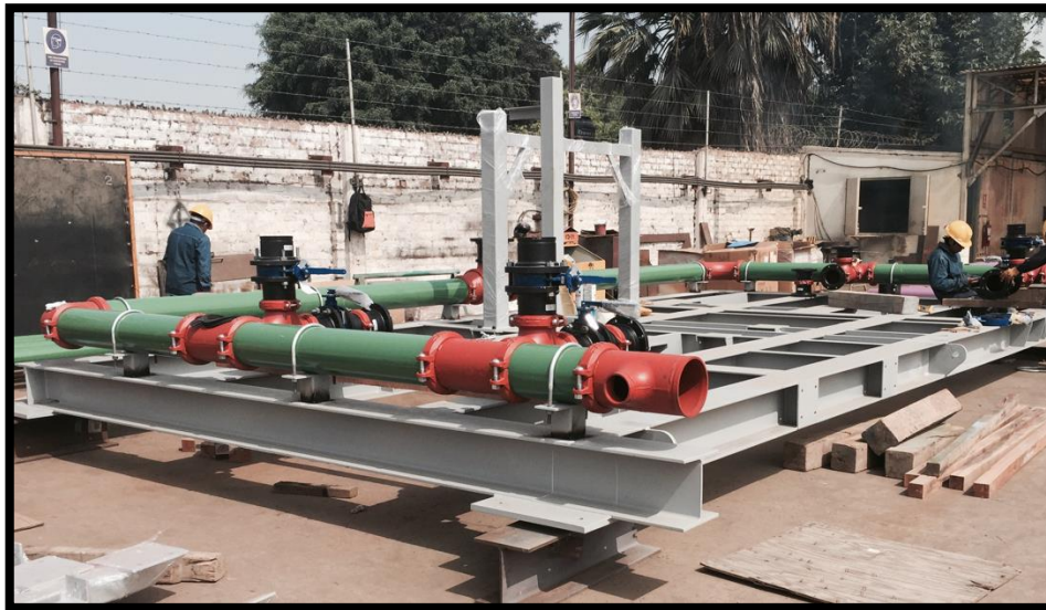
Figura 16: Estructura soporte de skip de bombeo de floculante de relave. Fuente: Propia. (2016).
