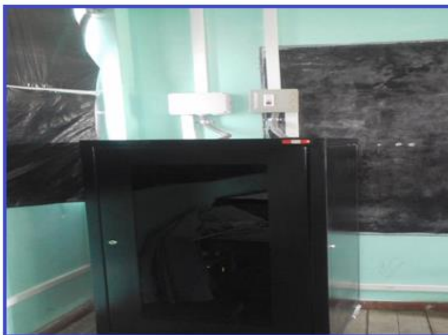
Fig. 4.4: Gabinetes de piso y pared
