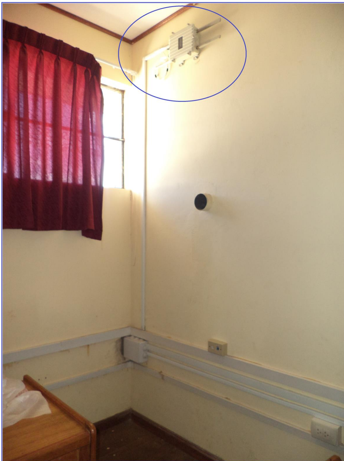
Fig. 4.1: Acces point instalado dentro de colegio.
